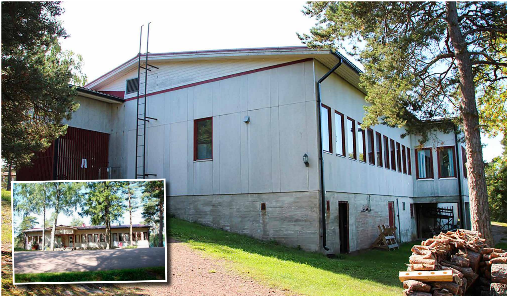
Församlingshemmet är i flitig användning om somrarna, men skulle behöva nya fönster, nya ytterväggar och nytt värmesystem. FOTO: JIM KARLSSON
