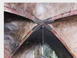
Branden har lämnat sotspår i taket.
