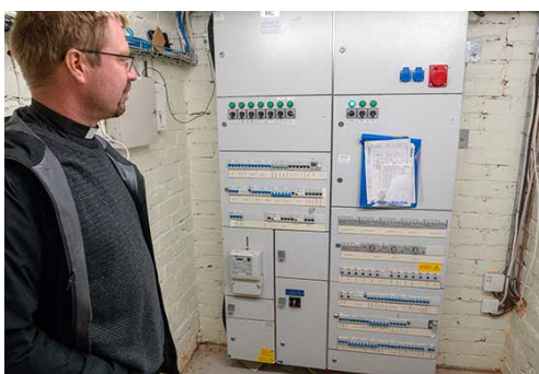
Tomi Tornberg vid elskåpet i Malax kyrka. Ifjol visade de en förbrukning på 31 108,25 kilowattimmar.
