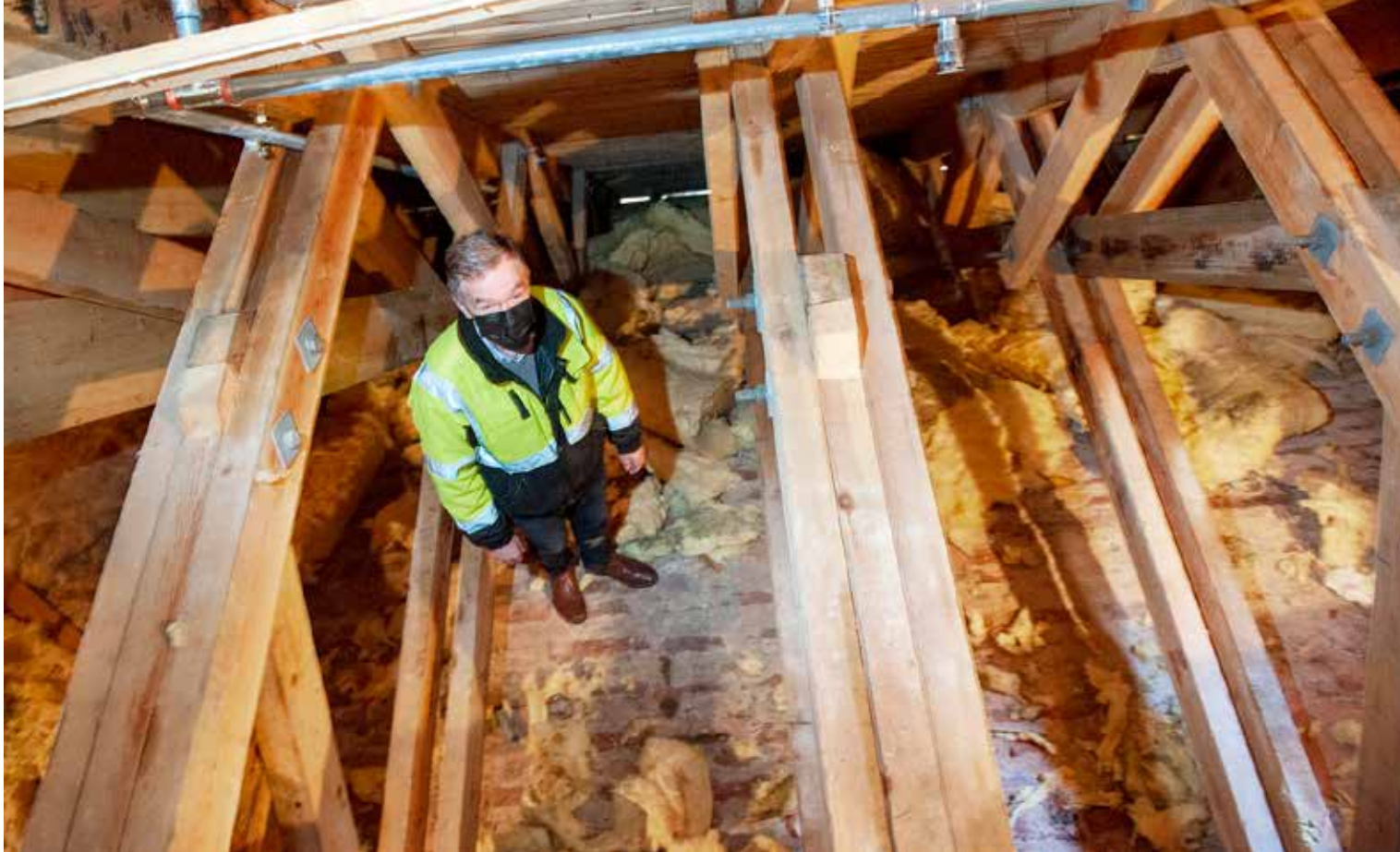
Det blottlagda takvalvet på vilket kyrkvaktmästaren Bengt Norrlin står är det synligaste tecknet på vattenläckaget. Brandverket slängde ut den våta isoleringen under det läckande munstycket.
