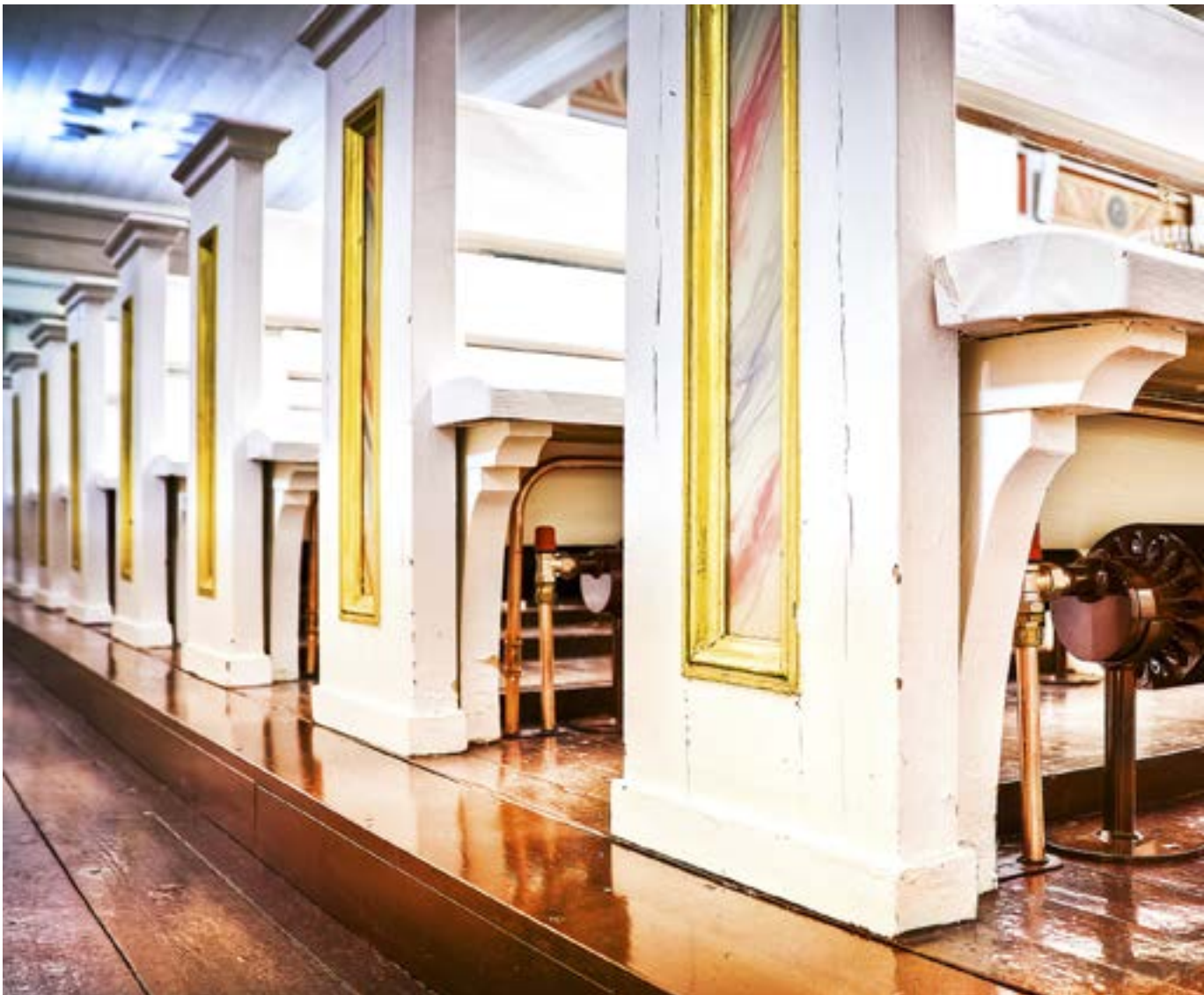
MÄNTYHARJU KYRKA finns i Södra Savolax och är Finlands näst största träkyrka. Värmeelementen under kyrkbänkarna byggdes i gammaldags stil och i enlighet med musieverkets bestämmelser så att de skulle passa in i den övriga miljön. FOTO: SENERA OY
